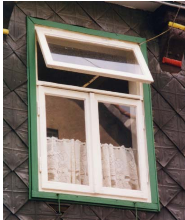
Vermeidbare Energieverluste entstehen Jahr für Jahr durch diese einscheibenverglasten Fenster.
