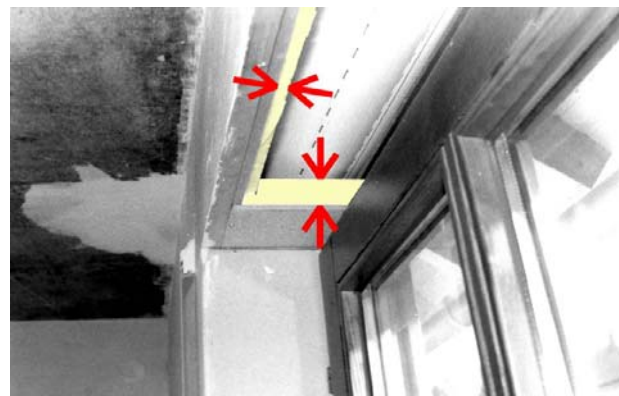
Der Rollladenkasten, dessen inneres mit der kalten Außenluft in Verbindung steht, sollte möglichst gut gedämmt sein. Bei diesem Kasten ist die Dämmung nachträglich angebracht worden. Im Neubau sind außen vorgesetzte Kästen die bessere Lösung
