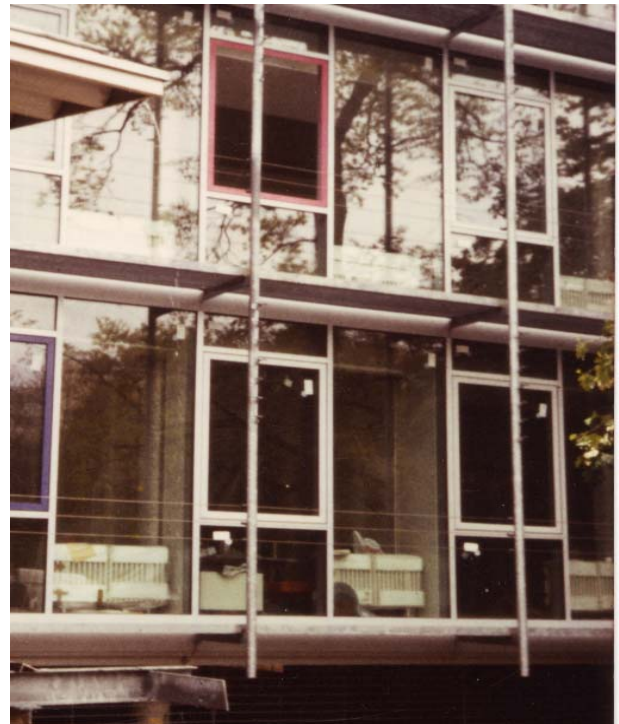
Bei diesem 1992 errichteten Bürohaus in Südhessen wurden mehr als 50 Heizkörper ohne Abdeckung direkt vor die Verglasung gesetzt.
